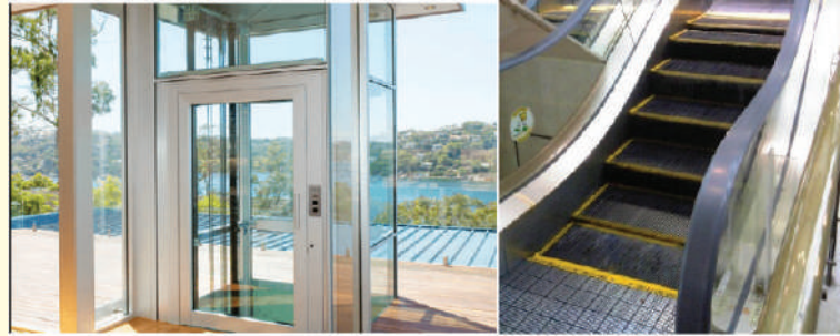
الشكل (1-90): الدرج الكهربائي، والمصعد الكهربائي.
