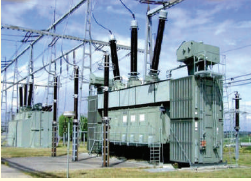
الشكل (1-84): محطة تحويل.
