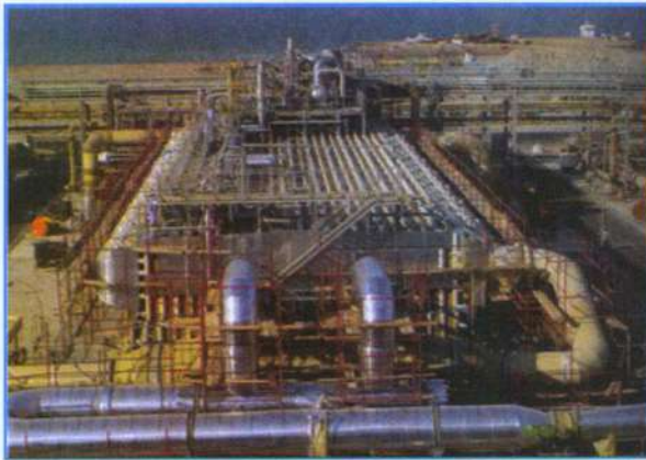
شكل (٢٤) محطة تحلية المياه في بركاء
