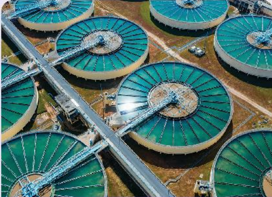
محطة معالجة مياه الصرف الصحي
