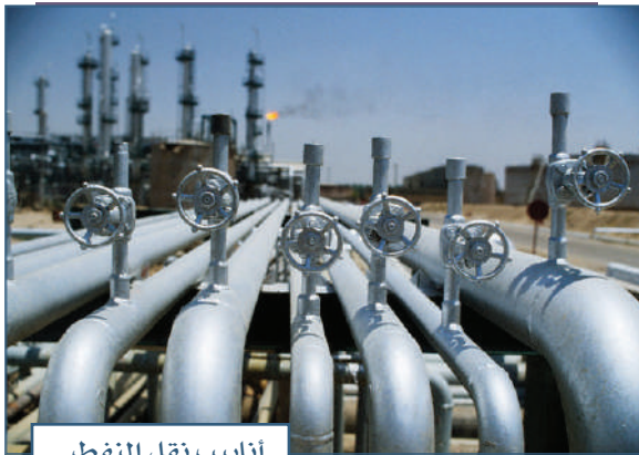
أنابيب نقل النفط
